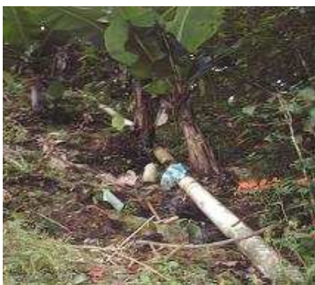
Figura 68: Tubería de las descargas de efluentes líquidos de la bodega Loma de Paramito
